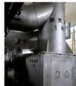
ダイオキシン除去装置
